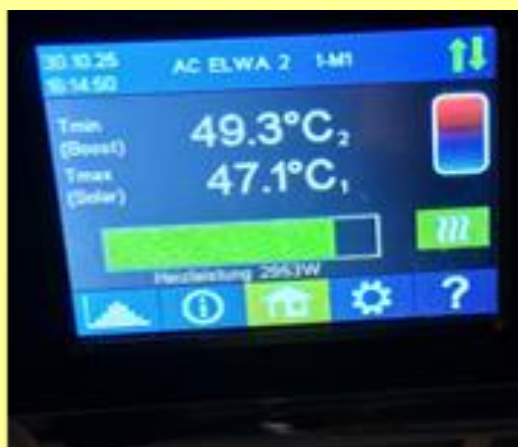
Impostazione della temperature acqua calda boiler all'elemento riscaldante
